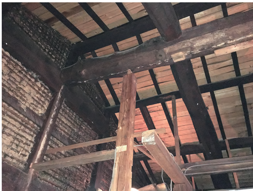
不安定な柱と梁
